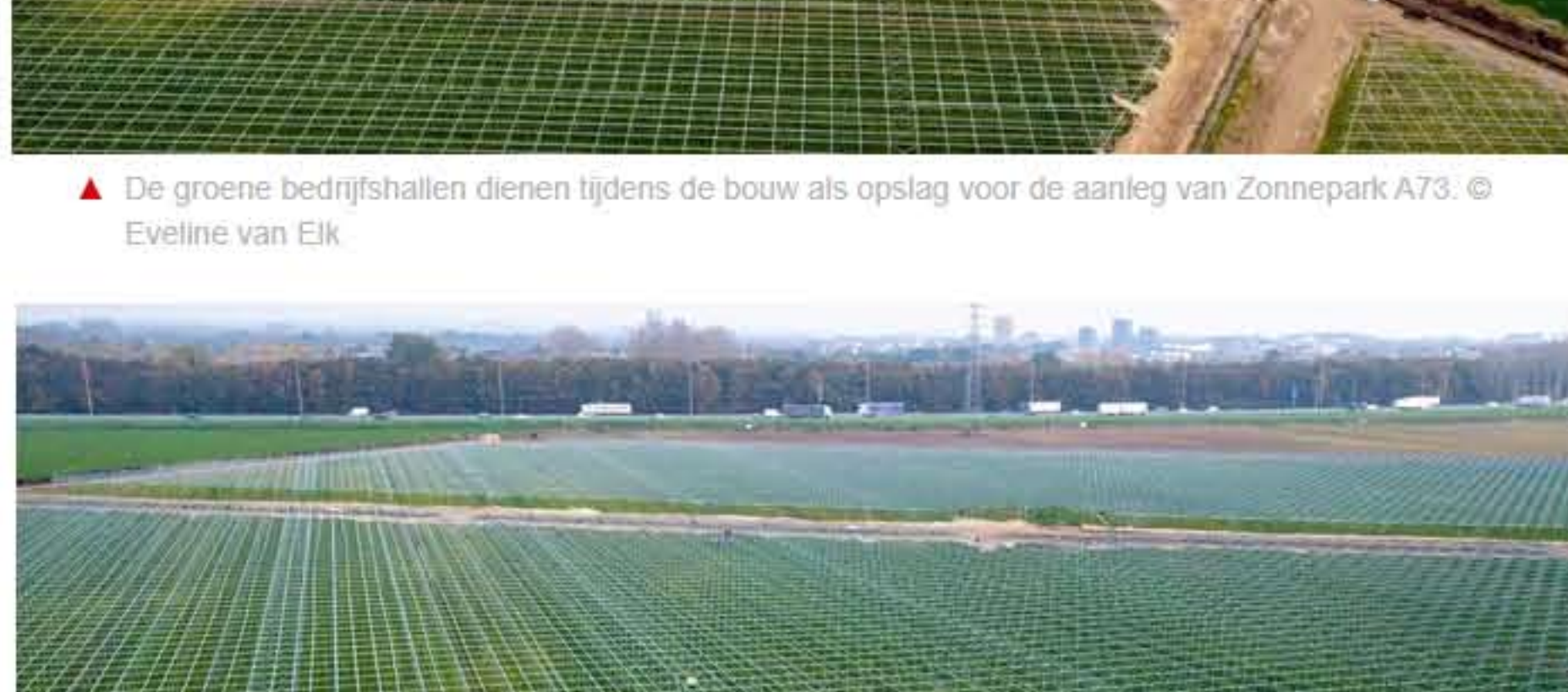
▲ De gele stippen op deze foto zijn werknemers die aan het werk zijn onder de constructie waarop de panelen komen te liggen. Op de achtergrond de A73 en daar weer achter een deel van de skyline van Nijmegen. © Eveline van Elk
